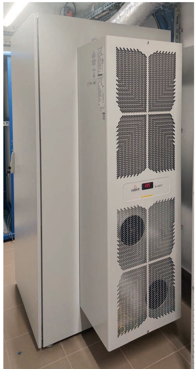
Klimatyzowana szafa krosownicza z zasilaniem awaryjnym
