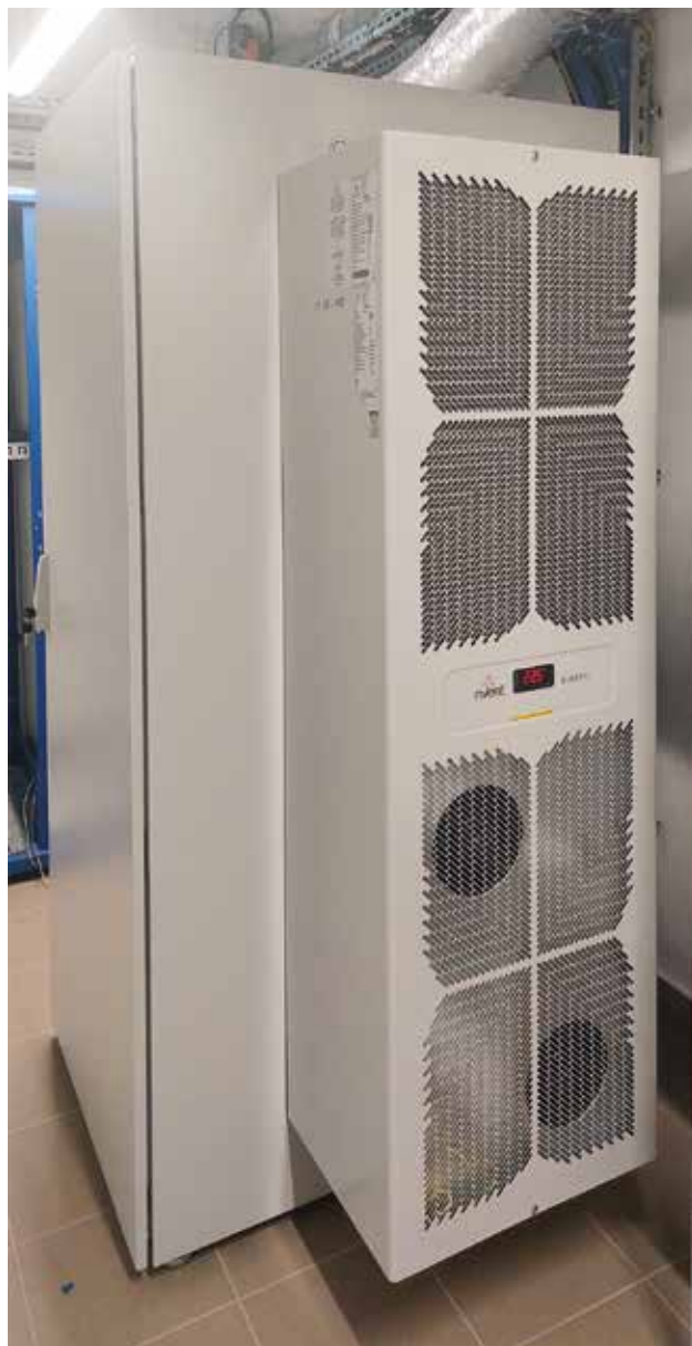
Klimatyzowana szafa krosownicza z zasilaniem awaryjnym
